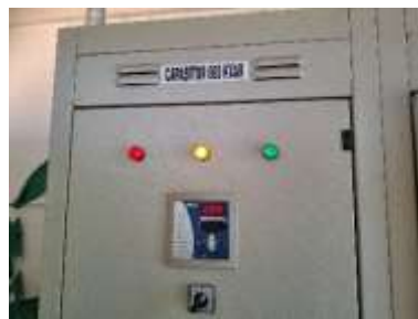
Gambar 7. Capacitor Bank Sumber: Dokumentasi Pribadi, 2025
