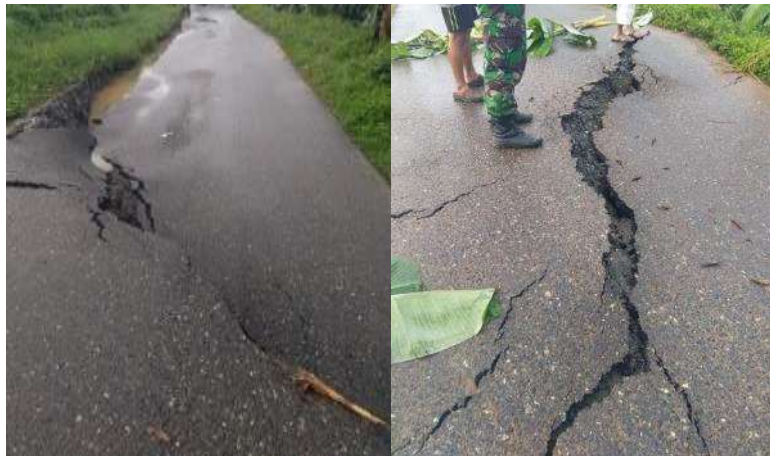
Gambar 1: Lokasi badan jalan yang amblas (3 Juli 2018)
