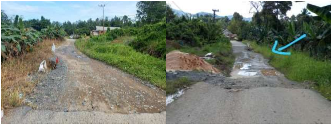
Gambar 2: Kerusakan jalan setelah mengalami amblas (25 Agustus 2020)
