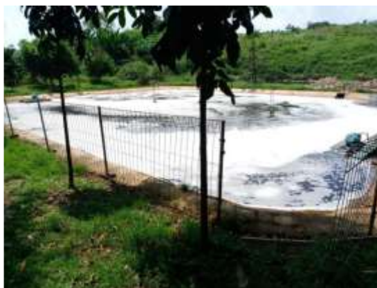
Gambar 3. Kolam Maturasi yang Difungsikan Sebagai Kolam Aerasi
