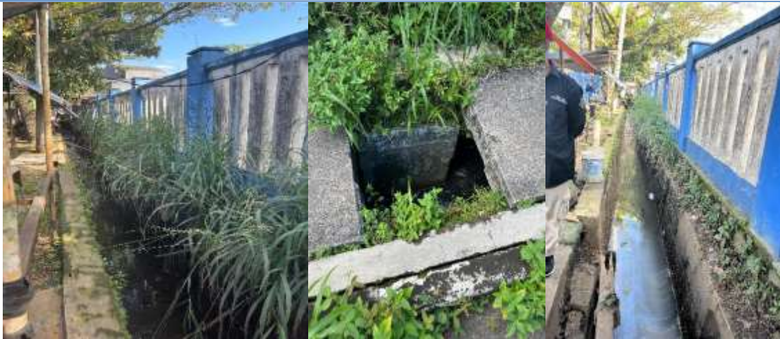
Gambar 2. Kondisi Eksisting Saluran Drainase Sumber : Hasil Penelitian, 2025
