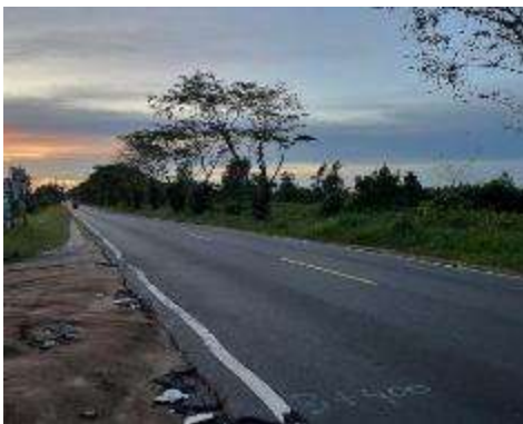
Gambar 9. Segmen 4 Kondisi Jalan Rusak (STA 2+400 - 2+500)
