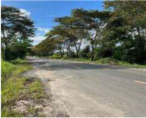
Gambar 13. Segmen 6 Kondisi Jalan Rusak (STA 5+100 - 5+200)
