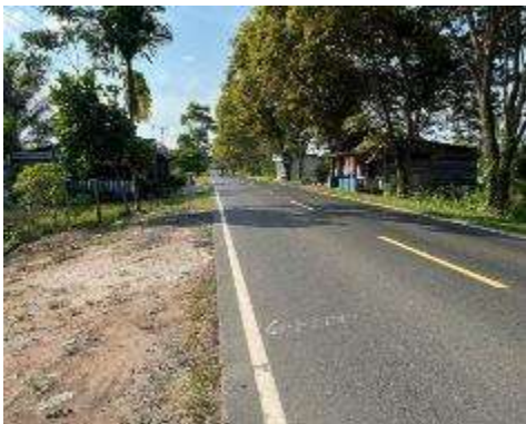
Gambar 15. Segmen 7 Kondisi Jalan Rusak (STA 6+200 - 6+300)
