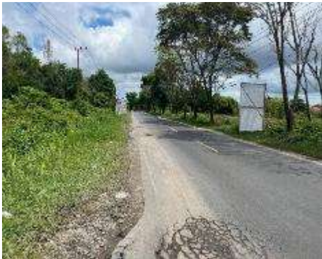
Gambar 3. Segmen 1 Kondisi Jalan Rusak (STA 0+500 - 0+600) Sumber: Dokumentasi Penulis (2025)
