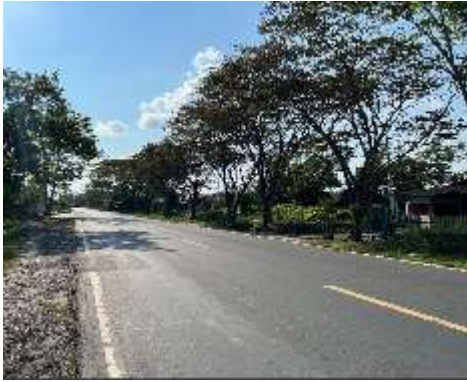
Gambar 7. Segmen 3 Kondisi Jalan Rusak (STA 2+400 - 2+500)
