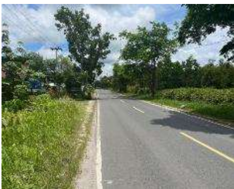
Gambar 5. Segmen 2 Kondisi Jalan Rusak (STA 1+100 - 1+200) Sumber: Dokumentasi Penulis (2025)
