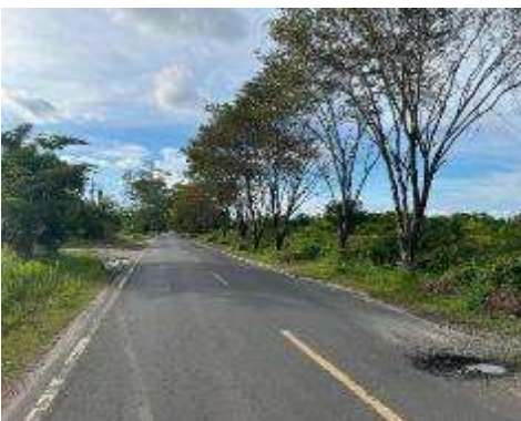
Gambar 11. Segmen 5 Kondisi Jalan Rusak (STA 4+900 - 5+000)
