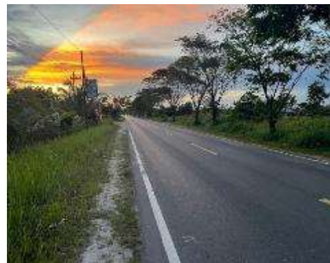
Gambar 10. Segmen 4 Kondisi Jalan Rusak (STA 2+400 - 2+500)
