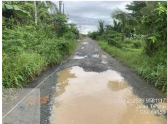
Gambar 2. Kondisi Jalan Teratai
