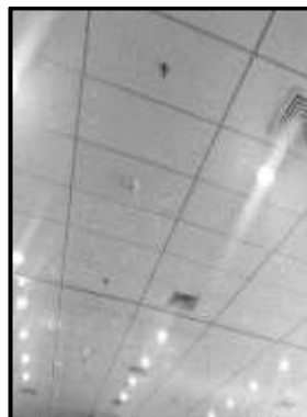
Gambar 5: Sistem Sprinkler dan alarm kebakaran
