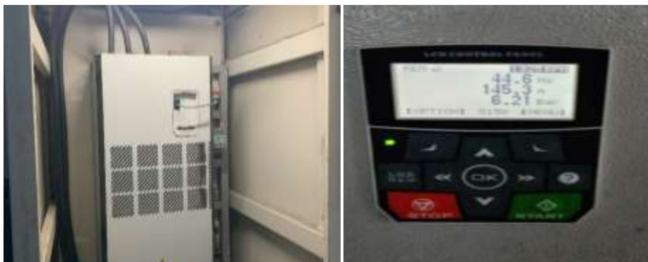
Gambar 3. Alat Ukur Parameter Listrik Power Meter Dilengkapi Logger Sumber : Dokumentasi Pribadi (2024)
