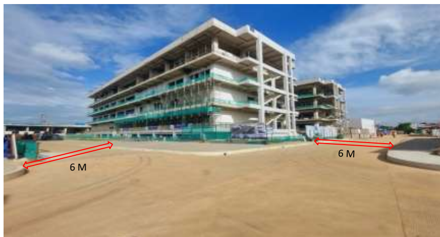
Gambar 6. Kondisi salah satu sudut jalur akses lapisan perkerasan Sumber: Dokumentasi pribadi
